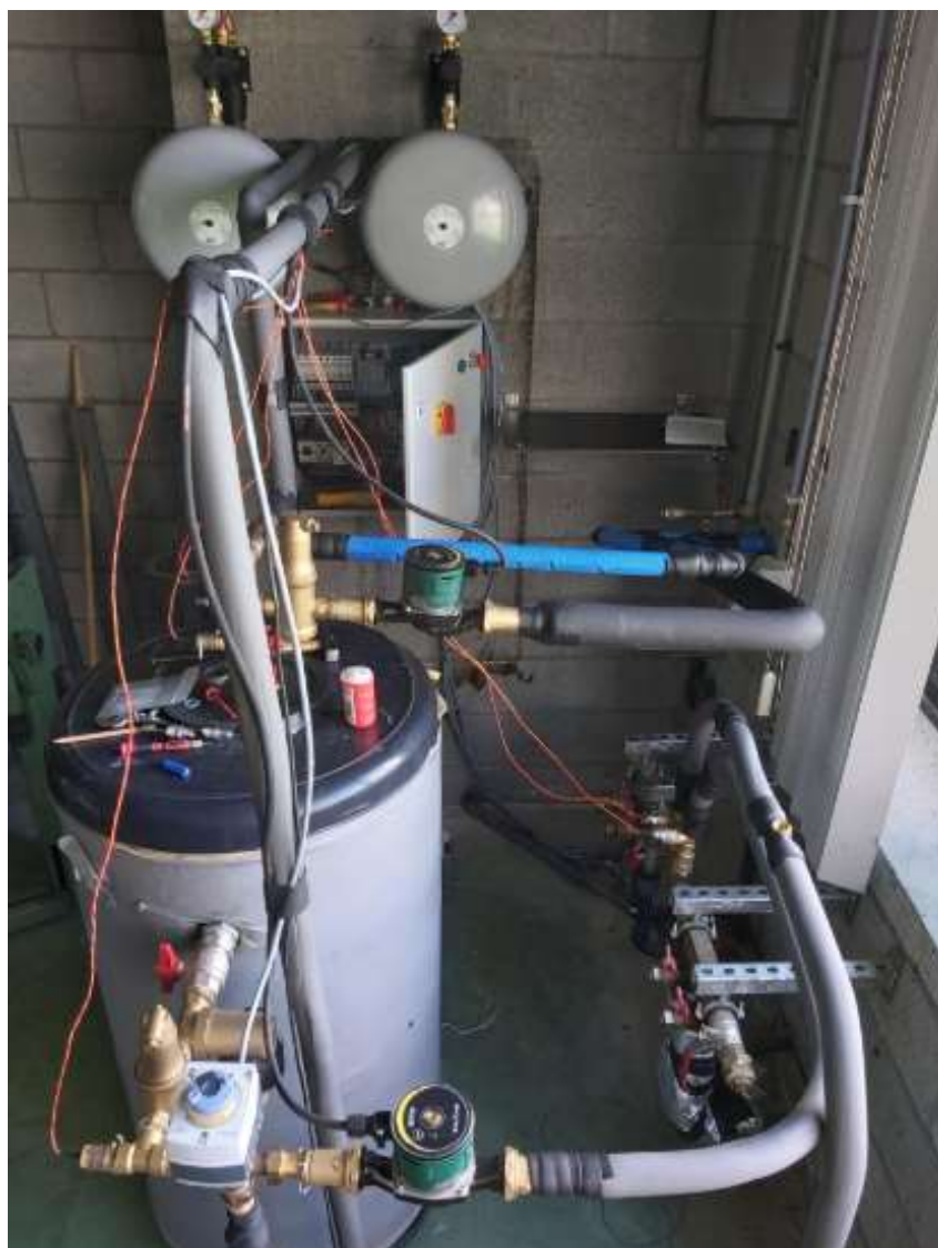
Figuur 35. Installatie Thomas More
