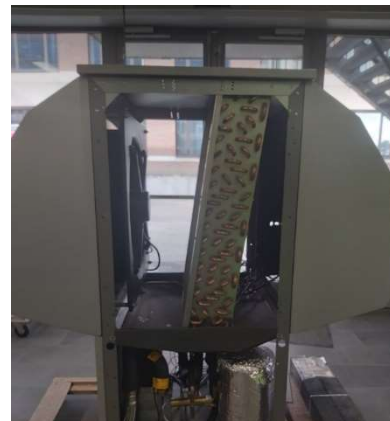
Figuur 37. Lucht-water warmtepomp.
